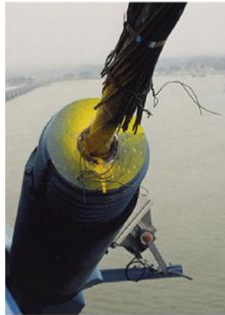
Figure I.18 : Dommages dus à la fatigue par frottement et à la corrosion de contact (Saint Pont de Nazaire, France). (Dieng .Helberet al,2013)
