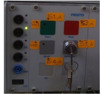
Figure II.4-3 Pupitre de la sous station de distribution
