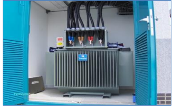
Figure 117 : Poste de transformateur
