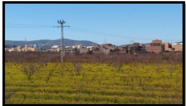
Figure 106 : Des poteaux d'électricité de moyenne tension
