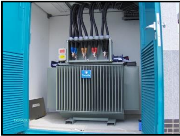
Figure 180 : Poste de transformateur
