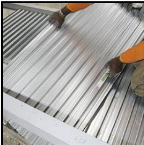
Le bac collaborant (16 mm d'ép.) prend forme à l'aide de plaques de tôle manuelles, installées sur toute la surface.
