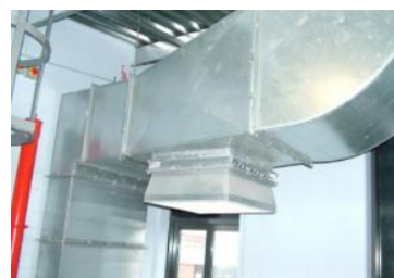
Figure 178: Systèmes de pressurisation Colt
