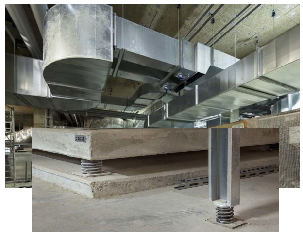
Figure 93: Les centrales de traitement d'air sont isolées du sol par des boîtes à ressorts
