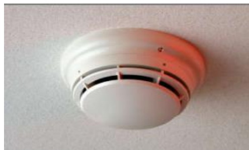
Figure 165:détecteur de fumée
