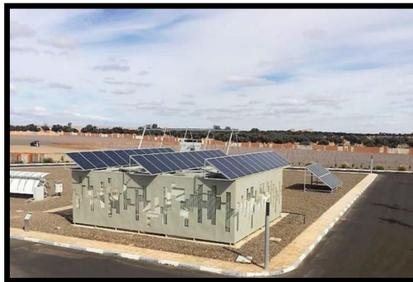
Figure49. La station pilote a été installée au Green Energy Park (Source : http://www.greenenergypark.ma )
