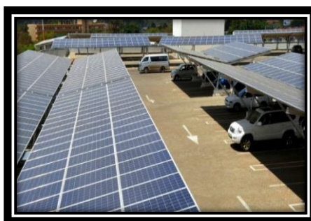
Figure 56: abri-parking avec panneaux solaires Source: www.enerzine.com .
