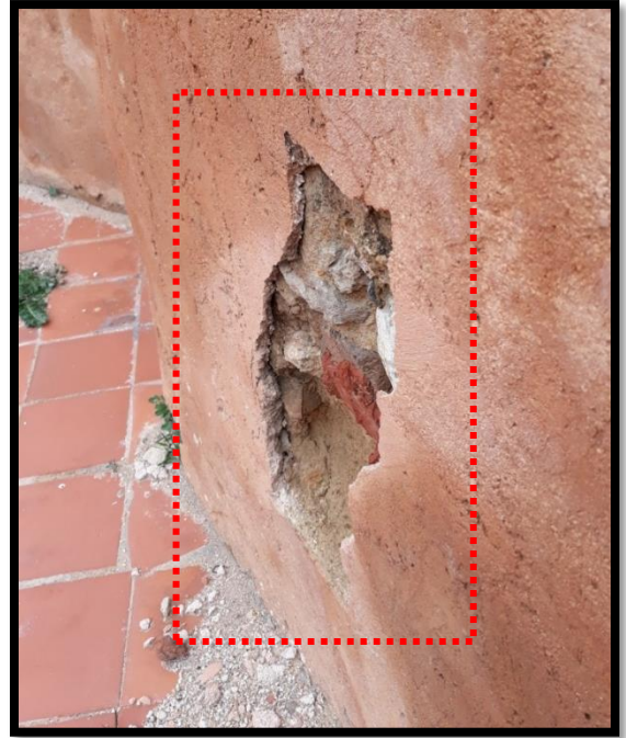
الصورة رقم 36: سقوط التليبس وسط الجدار
