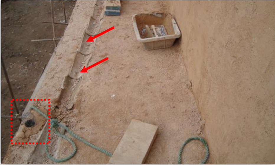
الصورة رقم 24: قنوات لتصريف مياه الأمطار
