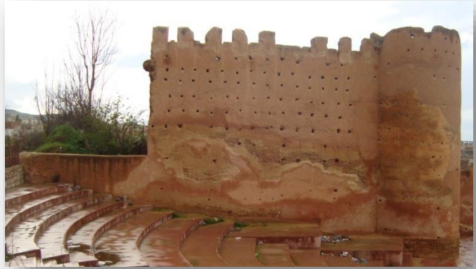
الصورة رقم 16: تلف وهشاشة الملاط بسبب الرطوبة
