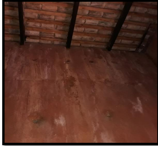
الصورة رقم 38: تسرب مياه الأمطار داخل الأبراج المربعة
