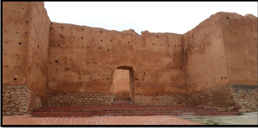
الصورة رقم 45: الرطوبة على مستوى المدخل والبرجين المربعين
