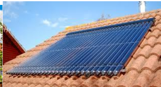
Figure 25:panneaux solaires thermiques
