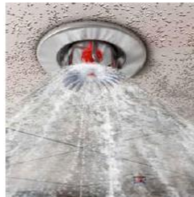
Figure 252:Extincteur automatique à eau
