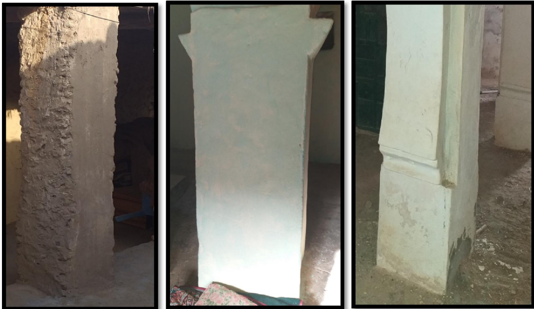
لوحة رقم (40): الدعامة المربعة المتمركزة بيت صلاة مسجد سيدي المدني (على اليمين) و المتمركزة بيت صلاة (في الوسط) و واجهة رواق (على اليسار) مسجد البوحميدي من تصوير الطالب-
