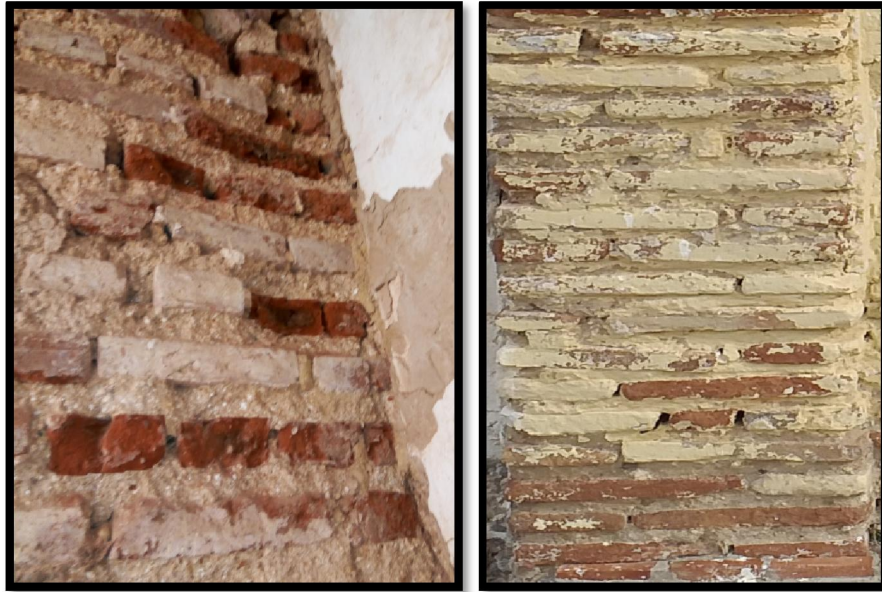
لوحة رقم (96): البناء بتقنية آدية و شناوي بمدخل مسجد سيدي المدني (على اليمين) و بجدران مسجد سيدي يعقوب (على اليسار) - من إعداد الطالب -
