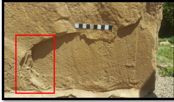
الصورة رقم: 34 تآكل الحجارة.
