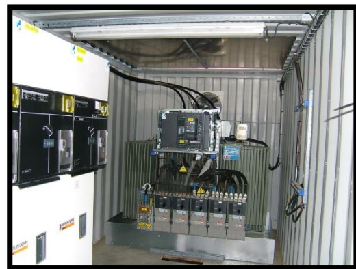
Figure 181 : Poste de transformateur. 182
