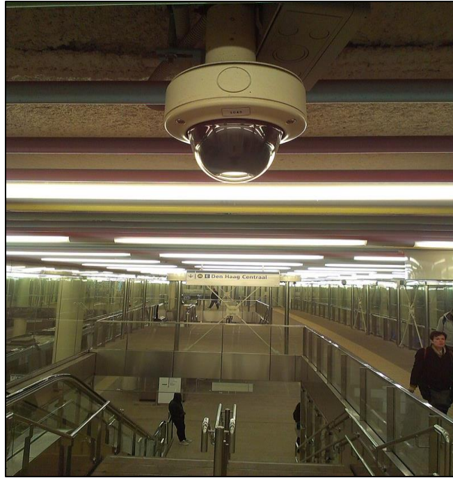
Fig. III.64 : Caméra de surveillance, type dôme (180°) dans une gare ferroviaire
