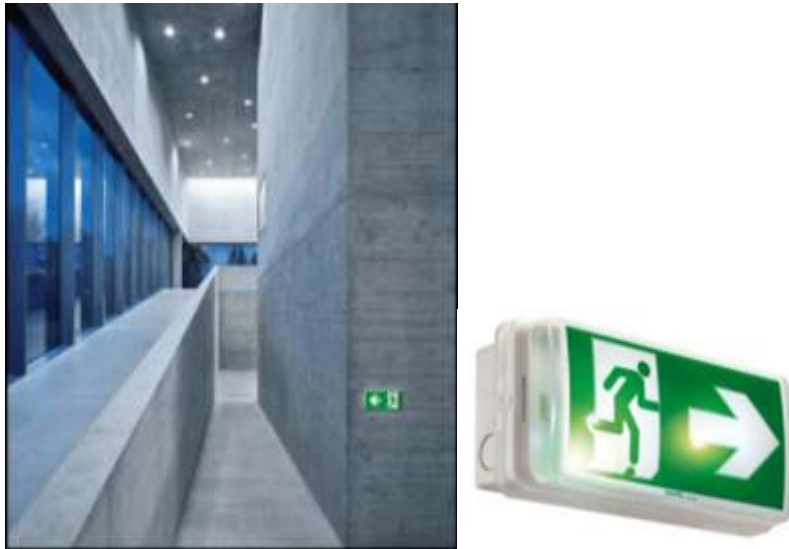
Figure 105: Exemple d'éclairage de sécurité et son emplacement
