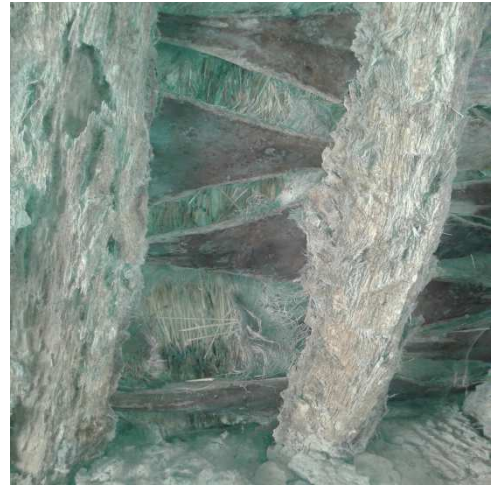
صورة 62: توضح تقشر وتآكل الخشب بفعل الرطوبة.
