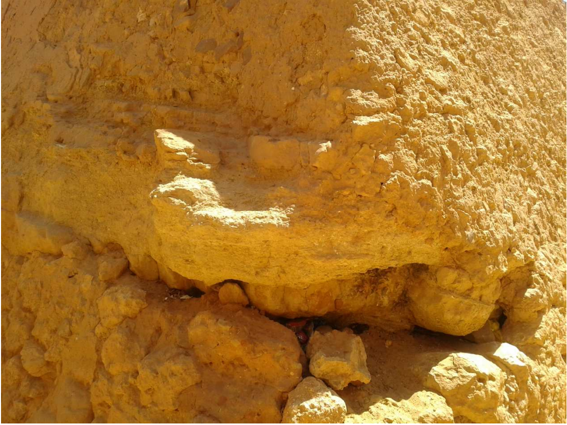
صورة 65: توضح تأثير الفئران بواسطة الحفر أسفل الأساسات كالبرج الجنوبي الغربي لقصة اولاد امحمد.
