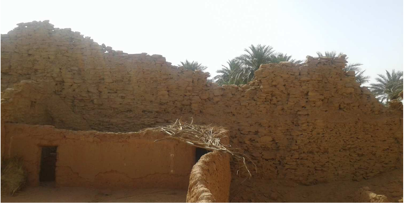
الصورة 13: صورة توضح تآكل الأجزاء العلوية للسور الشرقي لقصبة اولاد يعقوب.
