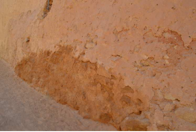
صورة 61: توضح هبوط الأساسات بفعل تغلغل مياه السقي.
