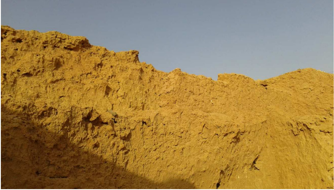
الصورة 10: صورة توضح الأجزاء المتآكلة من السور الجنوبي لقصبة تايلوت.
