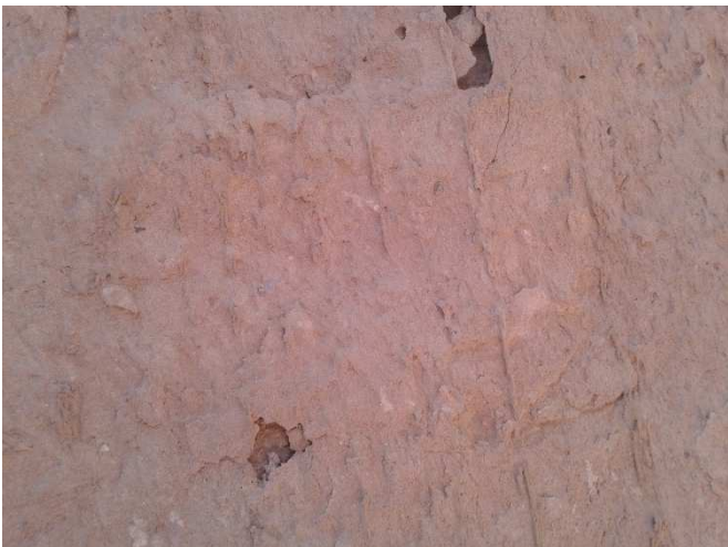
صورة 59: توضح تغلغل مياه الأمطار داخل الجدران للمخزن
