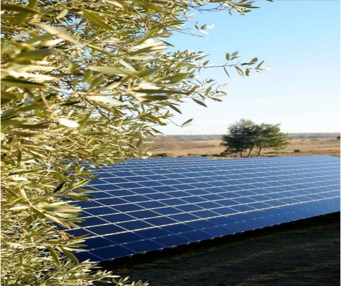
Figure 12 : La centrale solaire de La Narbonnaise (Aude) est équipée de 95.000 panneaux solaires au CdTe. Elle a été inaugurée le 18 décembre 2008. © H. Hôte (Agence Caméléon), EDF EN
