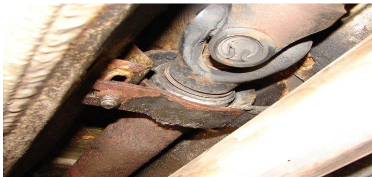
Figure II.5: défaillance des boulons.
