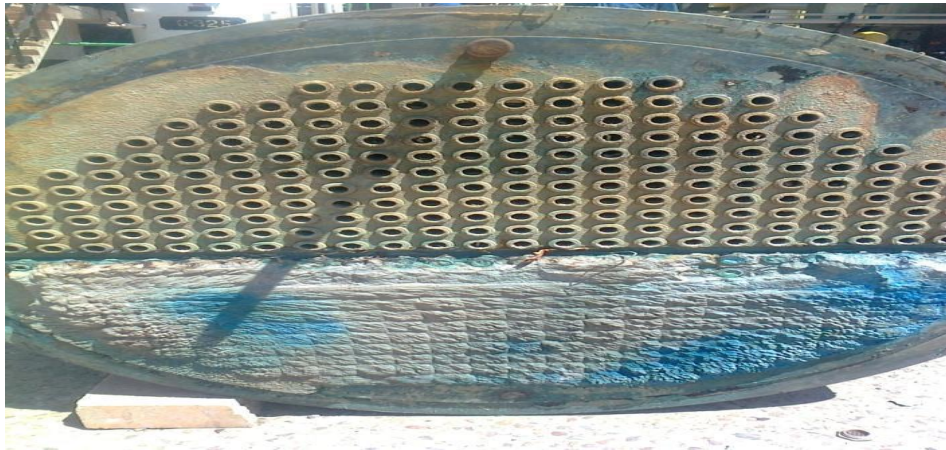
Figure III.2 : dépôt la tarte formée sur les faisceaux tubulaires de l'échangeur (photo réelle)
