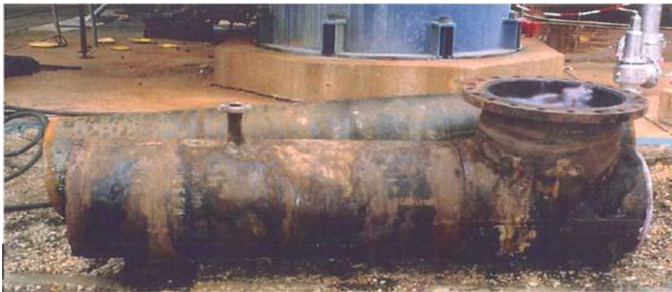
Figure III.5 : la corrosion (photo réelle)
