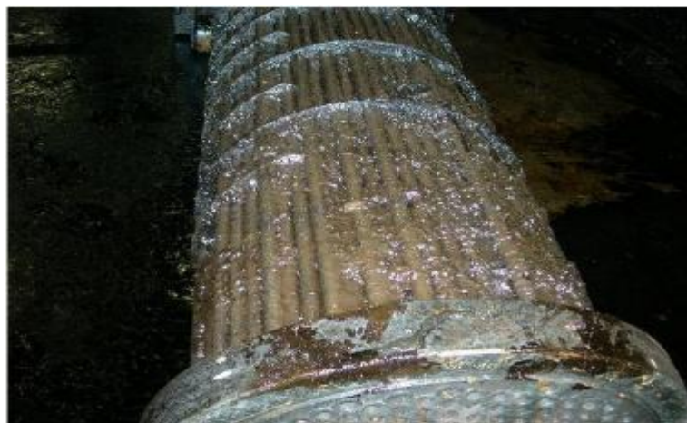
Figure III.1 : Encrassement de l'échangeur de chaleur (photo réelle)
