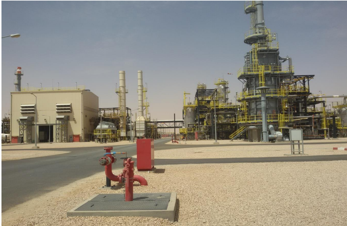
Figure I.6 : Unité boosting du CPF de la région de Rhourde Nouss [25]
