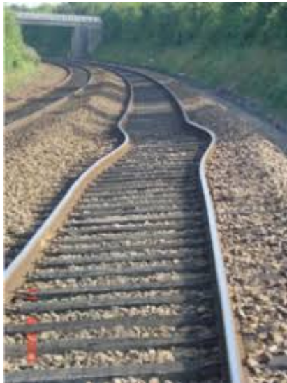
Figure 2 : Flambement de deux poutre long
