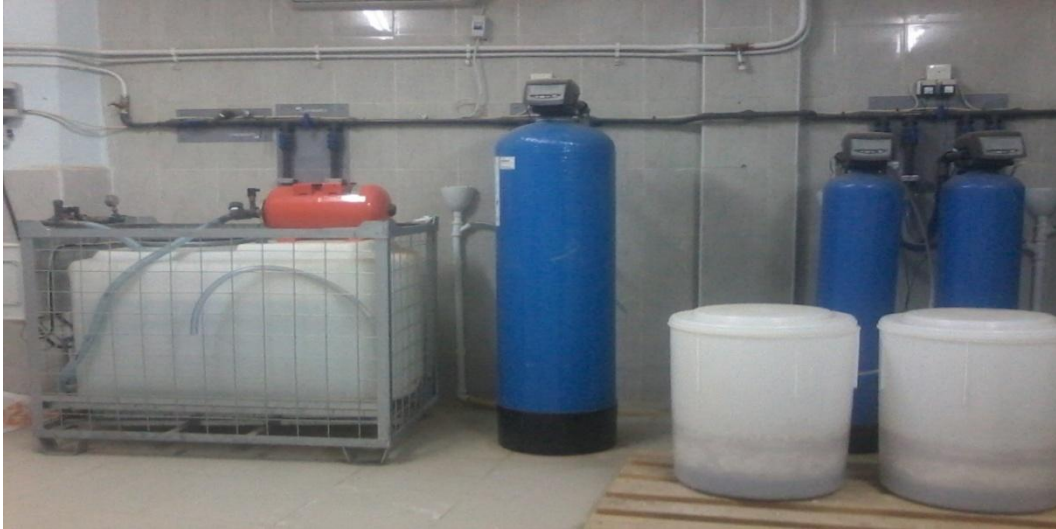
Figure I. 2- Un système de traitement d'eau.
