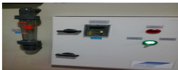
Figure I.11: Conductimètre et débitmètre à la sortie de l'osmoseur.
