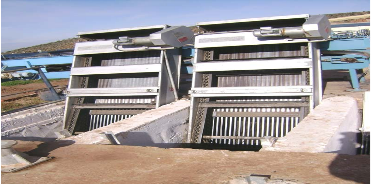
Grille mécanisée (2 unités).
