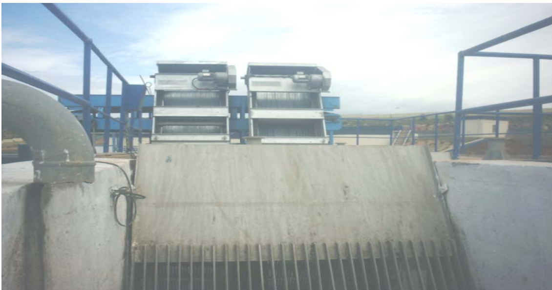
Grille grossière manuelle (1unité).
