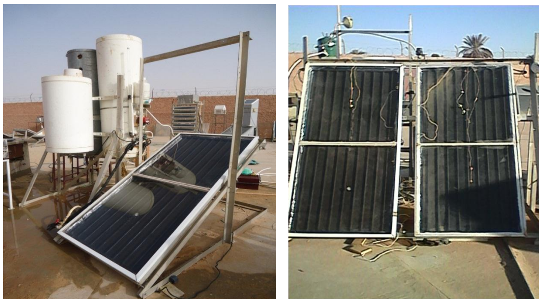
Figure N°48. Photo du chauffe-eau avec deux capteurs solaires plans réalisé à l'URERMS
