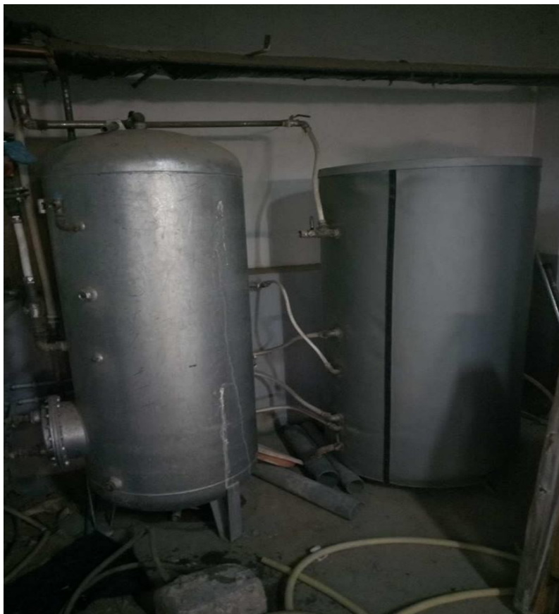
Figure 3-7 – b - : Ballons d'eau chaude
