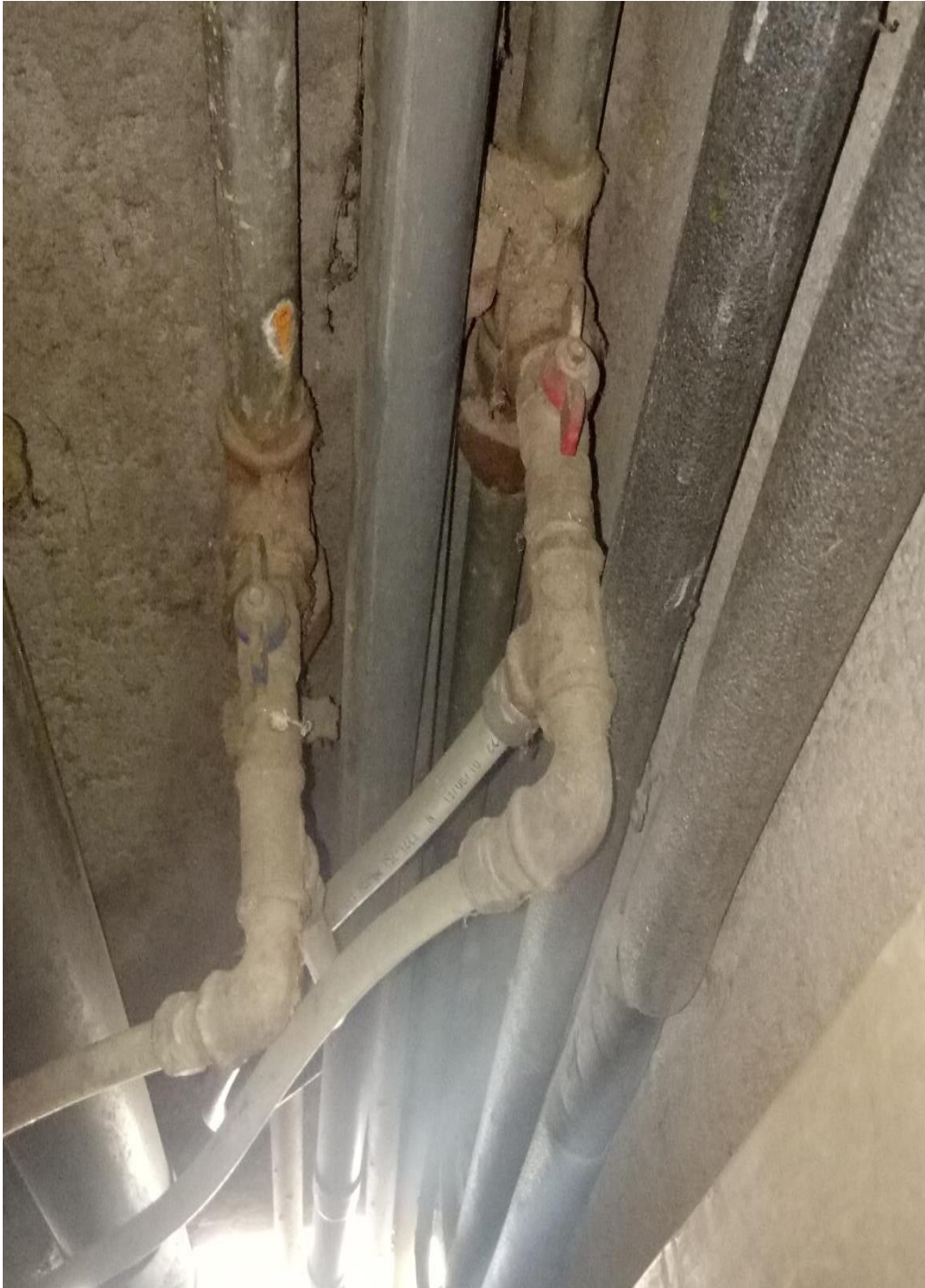
Figure 2-7 Conduites de distribution d'eau
