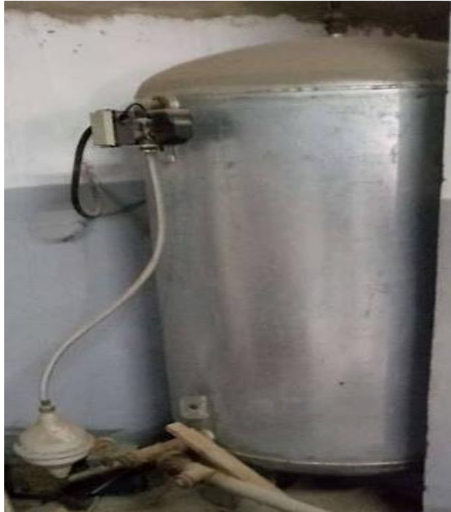
Figure 3-7 – a - : Ballon vessie Surpresseur
