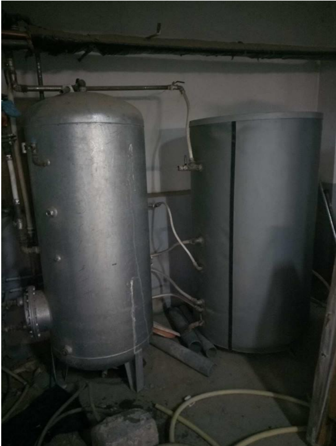
Figure 2-6 : Deux ballons d'eau chaude
