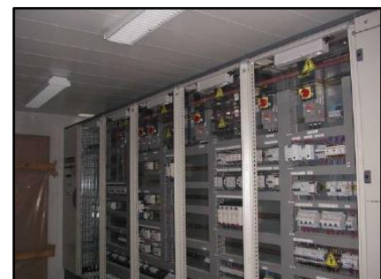
Figure 160 : les locaux techniques.
