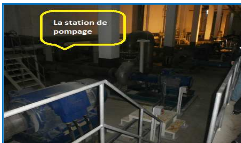
Photo.7: Station de pompage de Souk-Tleta. (Source : Rapport de stage, 2012).
