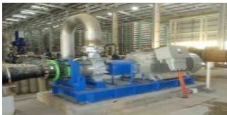
Photo.8: Photo Pompe à haute pression. (Source : SENHADJI, 2014).
