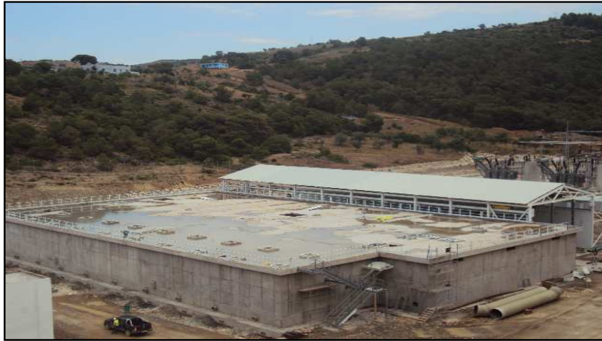
Photo.17: Réservoir de stockage de l'eau produite (Source : station de Dessalement 'Honaine')
