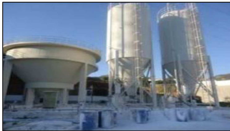
Photo.11: Site de stockage et de préparation de la chaux. (Source : SENHADJI, 2014)
