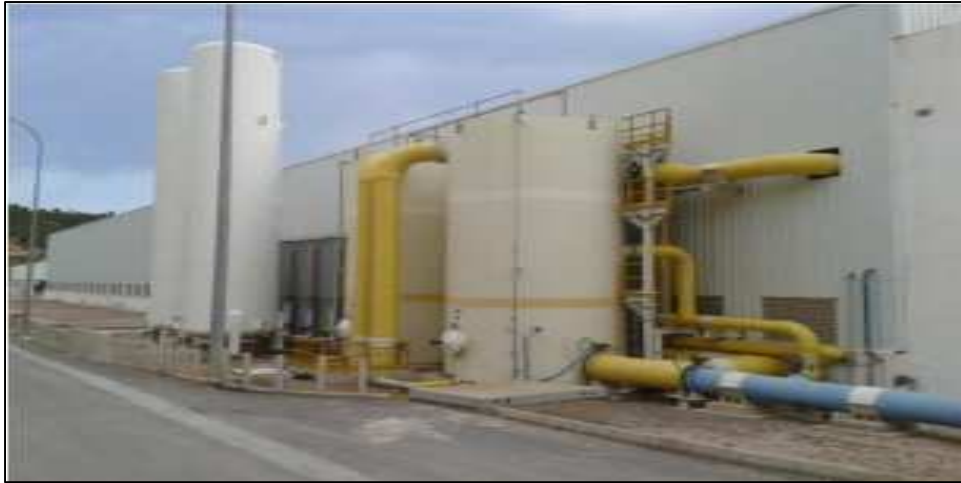
Photo.20 : Les réservoirs de CO 2 (Source : station de Dessalement 'Honaine')
