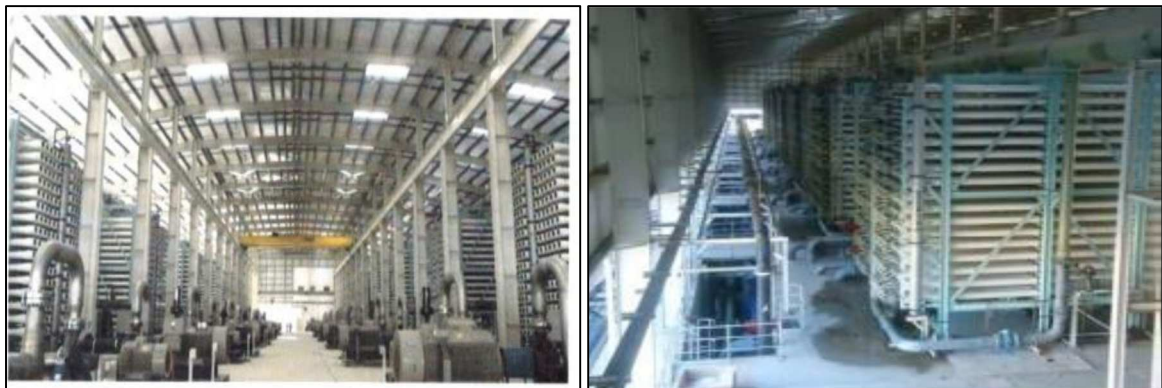
Photo.9: Unités d'osmose inverse. (Source : HACHEMAOUI, 2014)
