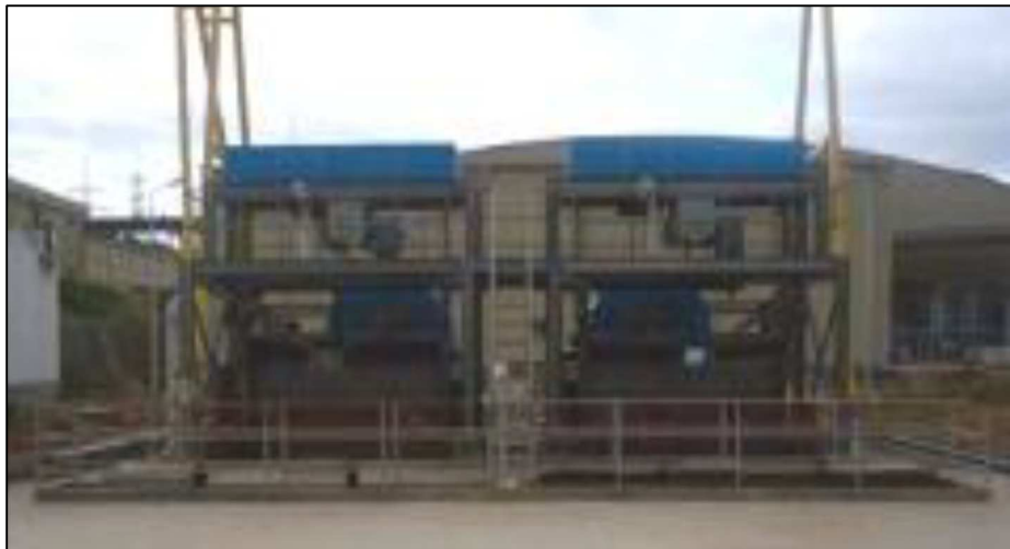
Photo. 3 : Les dégrilleurs grossiers. (source : HACHEMAOUI, 2014)
