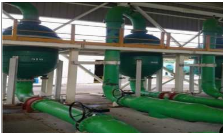
Photo.16 : Filtres à cartouches au niveau de la station (Source : station de Dessalement 'Honaine')
