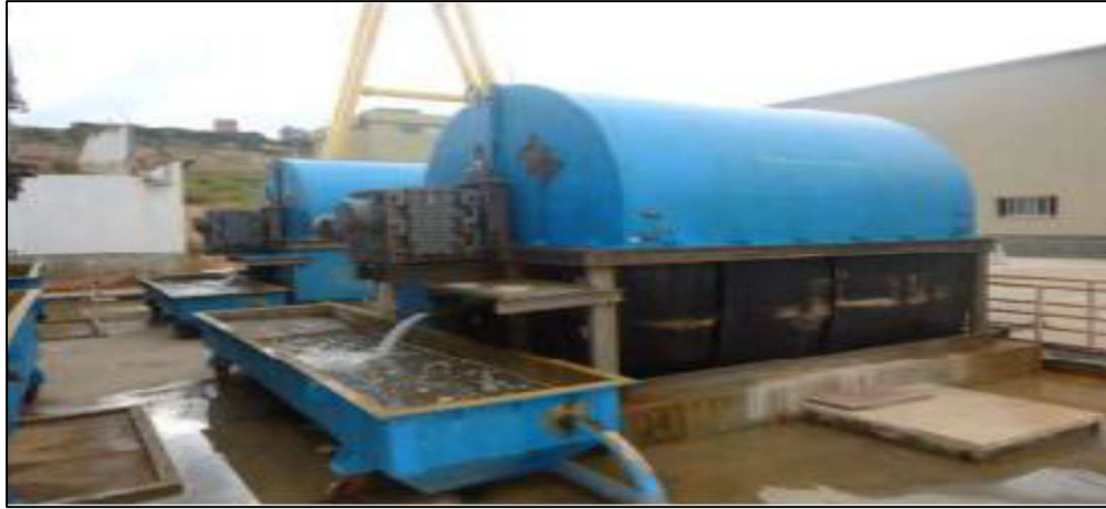
Photo. 4: Les Tamis-dégrilleurs fin rotatifs (Source : HACHEMAOUI, 2014).
