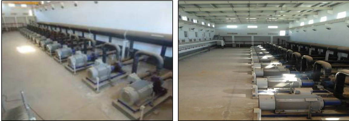
Photo.12: Station de pompage de l'eau traitée. (Source : SENHADJI, 2014)
