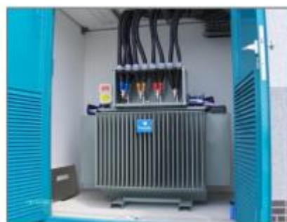
Figure 230 : Poste de transformateur
