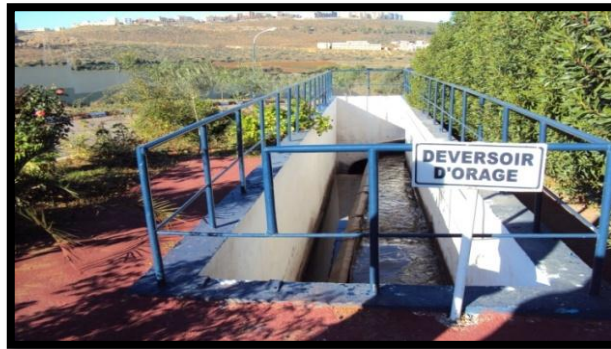
Figure 10:Le déversoir d'orage
