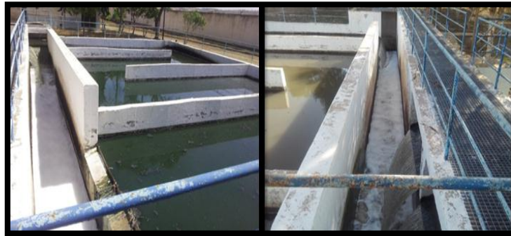
Figure 43 : bassin de chloration
