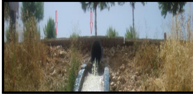
Figure 25 : Effondrement du mur
