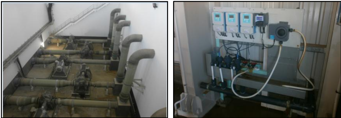
Figure III.14 : Les pompes de la station.
