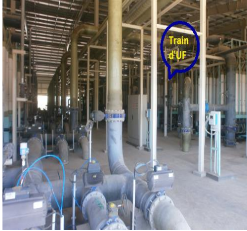
Figure III.15 : Système d'ultrafiltration filtration de la station.
