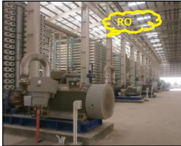
Figure III.19 : Chaîne d'Osmose inverse de la station.
