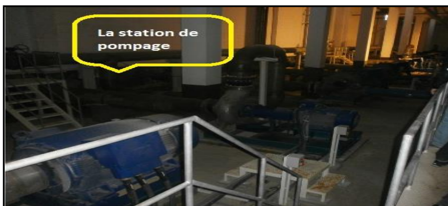
Figure III.18 : Réservoir de stockage d'eau filtré et station de pompage.
