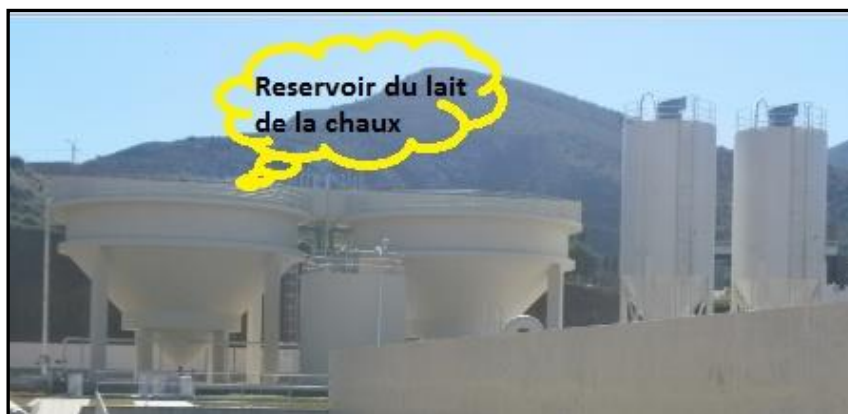
Figure III.23 : Réservoir de la chaux.
