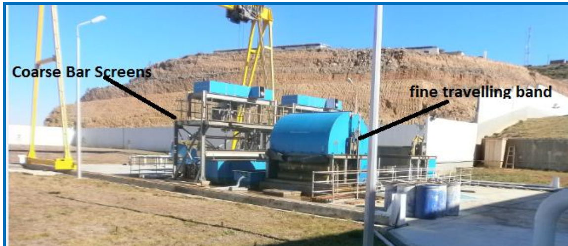
Figure III.13 : Dégrilleurs grossiers et Tamis fin.
