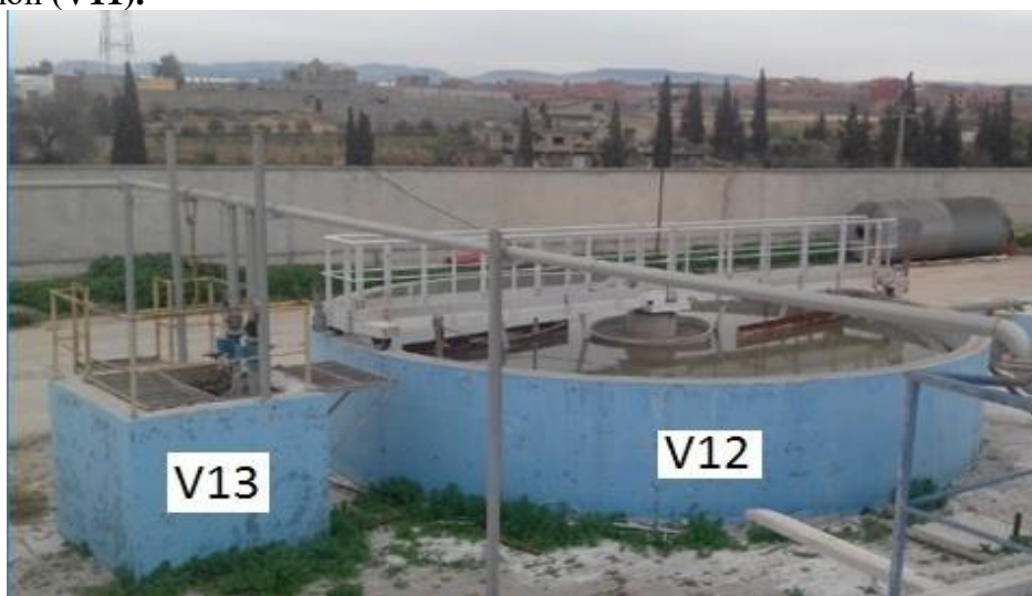
Photo.22: Sédimentateur dynamique (V12) et bassin de soulèvement boues (V13).
