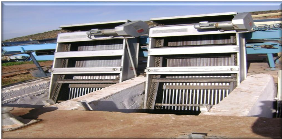
Figure II.11 : Grille mécanisée (2 unités) [30]
