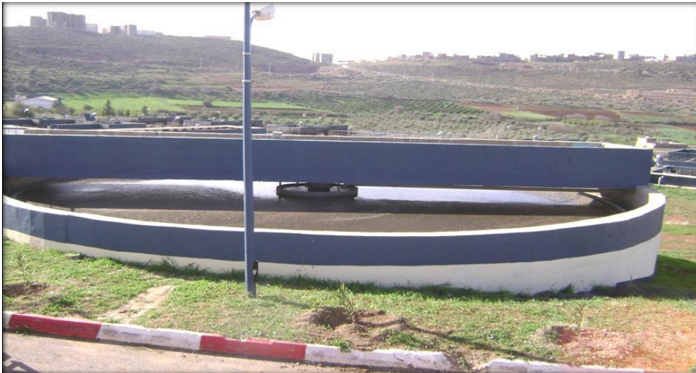
Figure II.17 : Epaississeur des boues [28]
