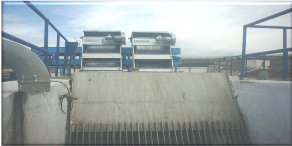
Figure II.10: Grille grossière manuelle (1 unité) [30]
