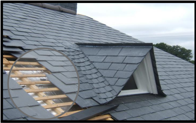
Figure 56 : Toiture en ardoise sur ferme en bois avec isolation en laine de roche
