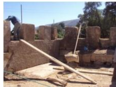
Figure 3 : En cours d'intervention sur la terrasse de la porte en chicane en 2010.
