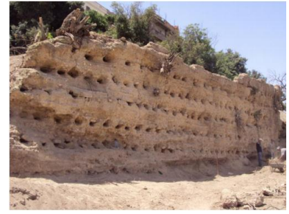
Figure 52 : Fragment de la muraille nord d'Agadir (face sud), lors des travaux d'aménagement en 2010.
