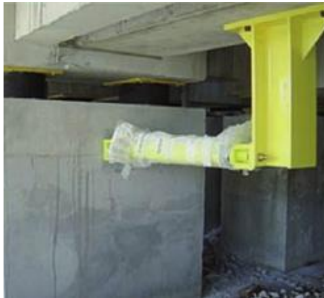
Figure 97 : un amortisseur placé à la structure pour réduire le mouvement du bâtiment
