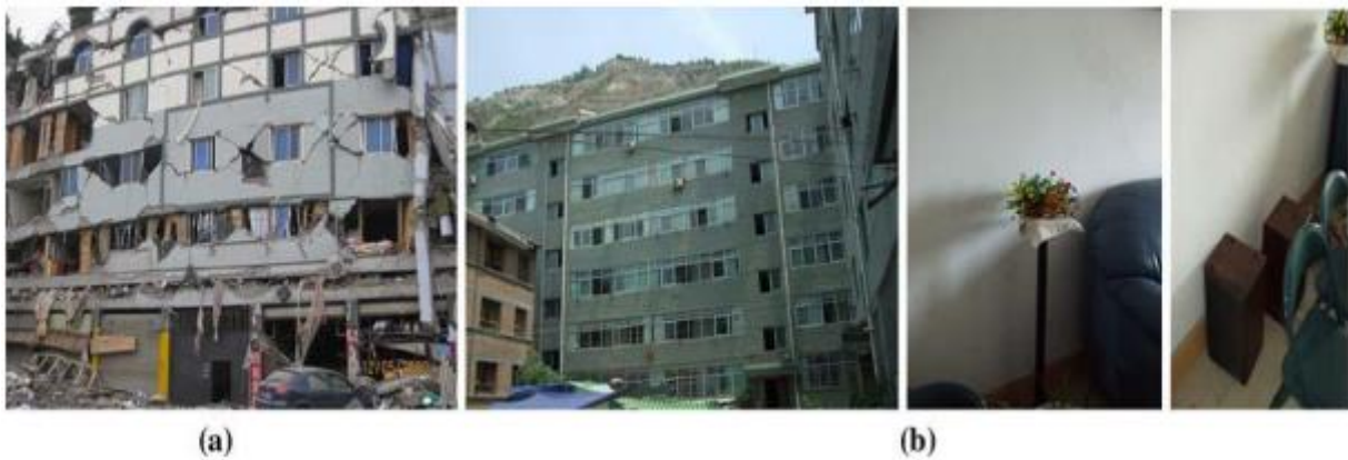
Figure VII.3 : Dommages dus au séisme de Wenchuan (Chine) en 2008 [8], (a) les dommages d'un bâtiment durant le séisme de Wenchuan en 2008, (b) absence des dommages structuraux et non-structuraux, dans un bâtiment isolé à la base durant le même séisme.
