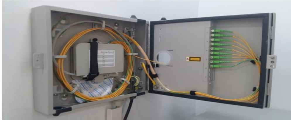
Figure IV.7: Boitier pied de l'immeuble BPI.
