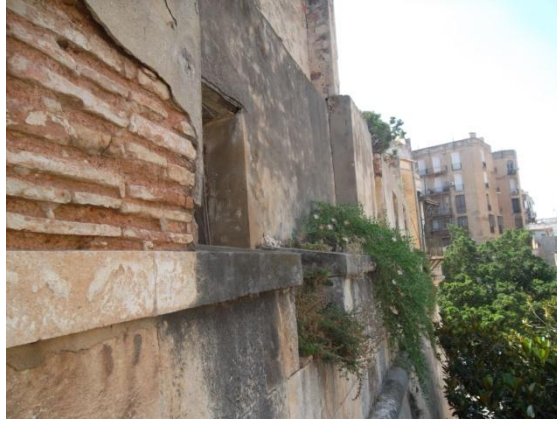
الصورة رقم 35 نمو نباتات على الجدار الخارجي لحمام القصر
