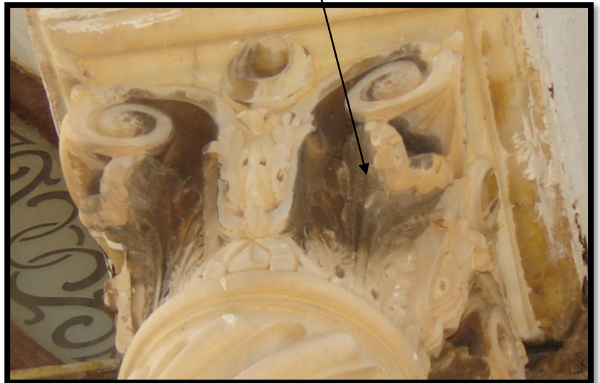
الصورة رقم 27 إصابة الرخام بطبقات سوداء
