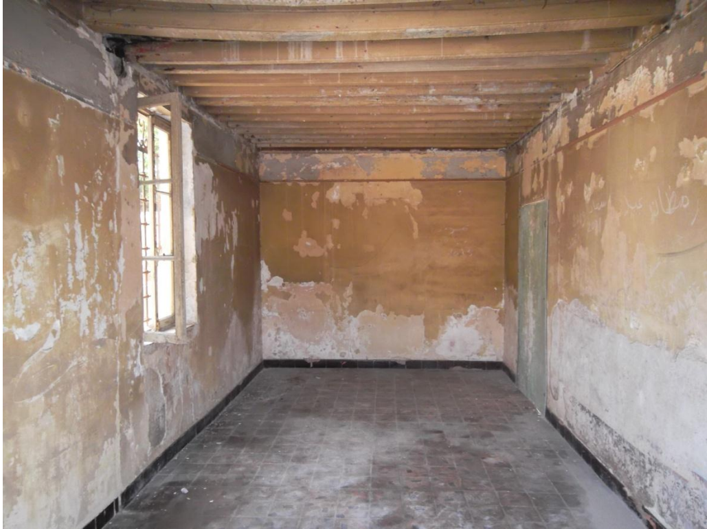
الصورة رقم 22 تشكل طبقات بيضاء بفعل الرطوبة
