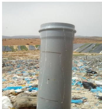
Figure 26:torchères de récupération du biogaz
