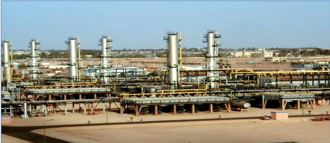
Figure 1.5. Vue partielle d'un train de traitement de gaz
