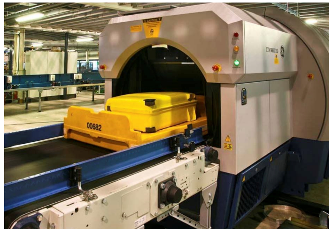
Figure 4.64: système de contrôle des bagages
