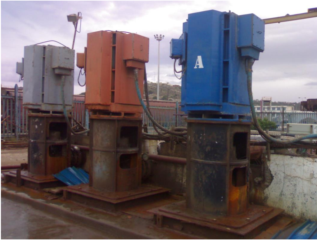
Figure III.13 : Pompes centrifuges principales
