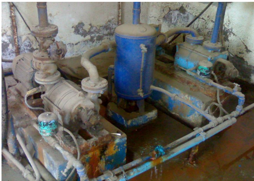
Figure III.8 : Deux pompes à vide avec le réservoir de circulation
