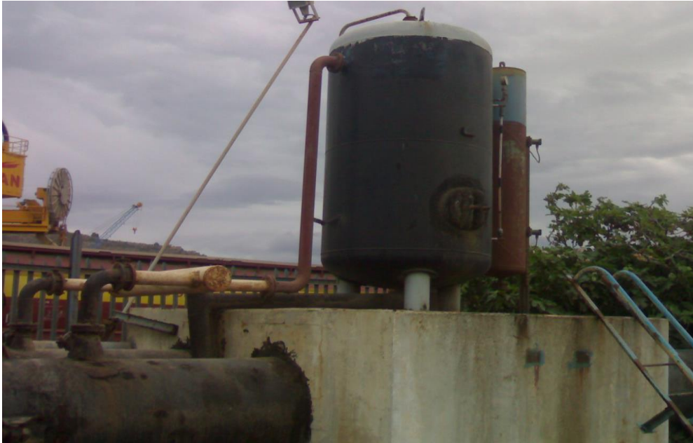
Figure III.9 : Réservoir de vide
