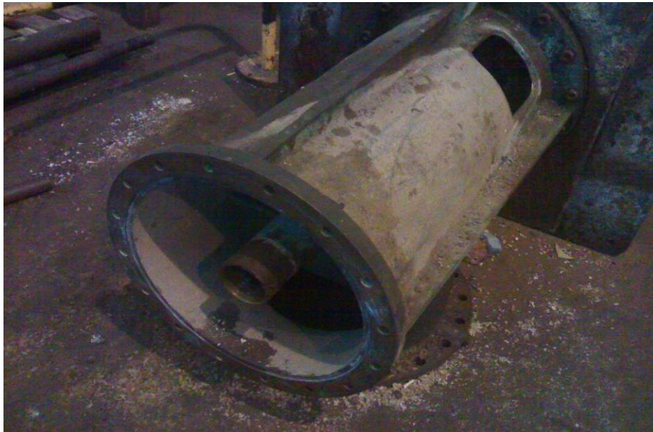
Figure III.16 : Conduite de refoulement
