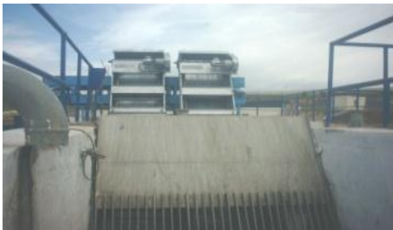
Figure n°2: le dégrilleur (original).
