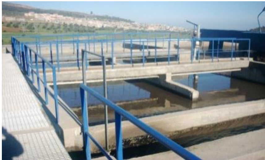
Figure n°5 : Bassin de nitrification (original). dénitrification.
