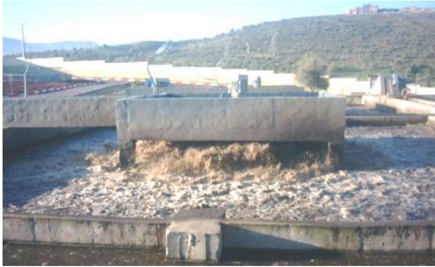
Figure n°4 : bassin d'aération (original).
