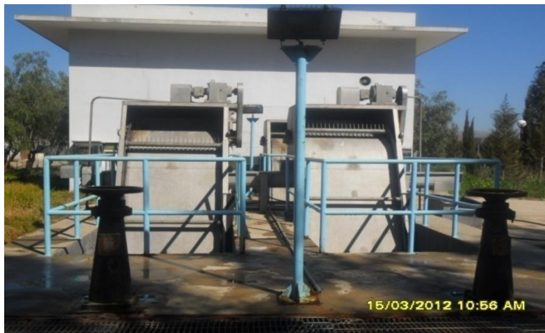
Figure III.3: des dégrilleurs (ONA, 2012)
