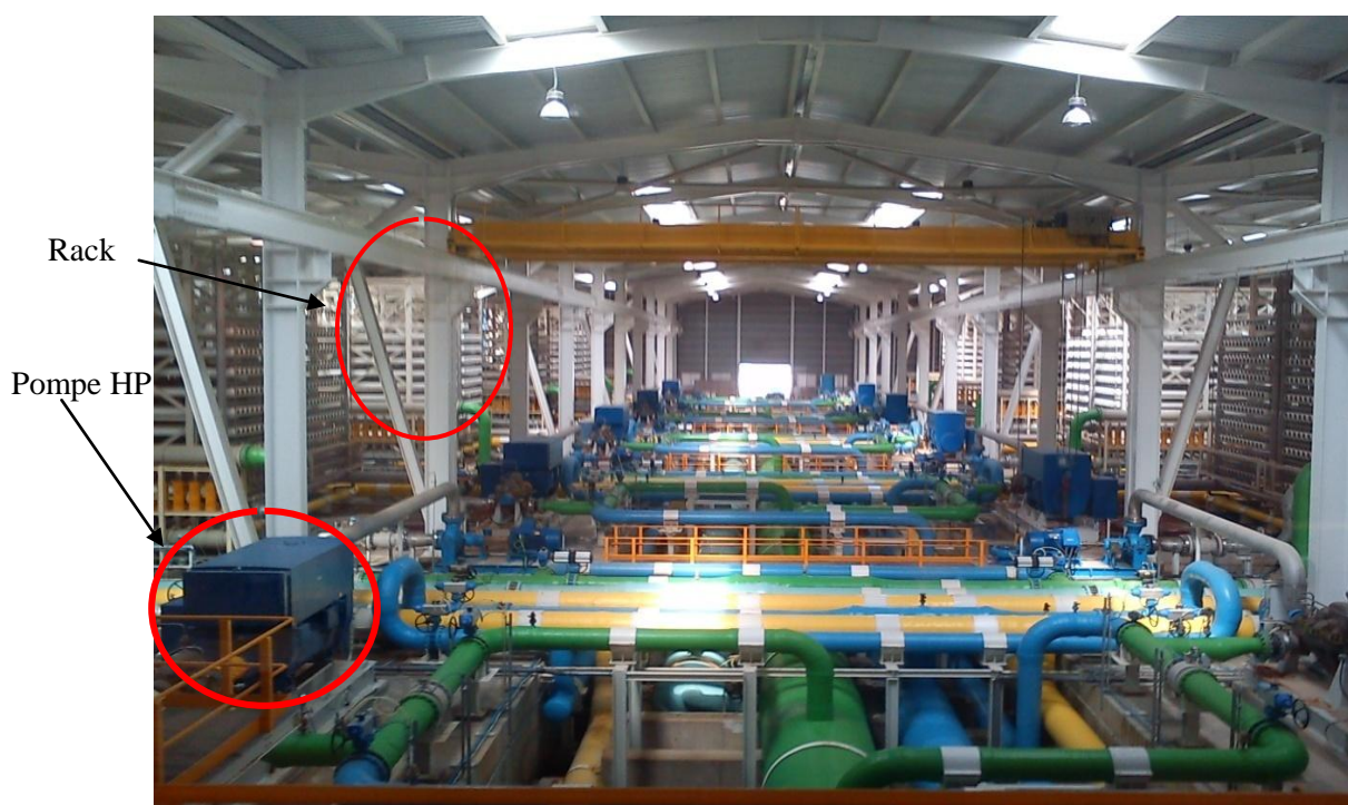
Figure III.11: Photo du bloc d'osmose inverse
