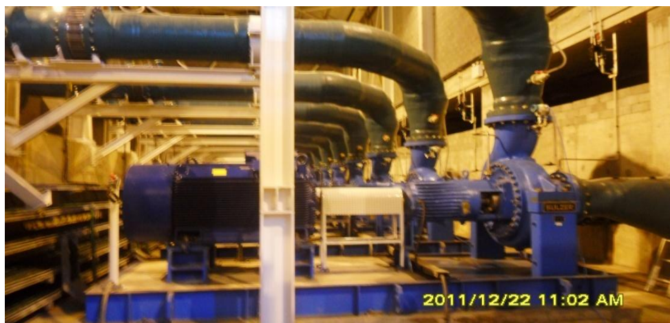
Figure III.4 : Photo du bloc de pompes de captation
