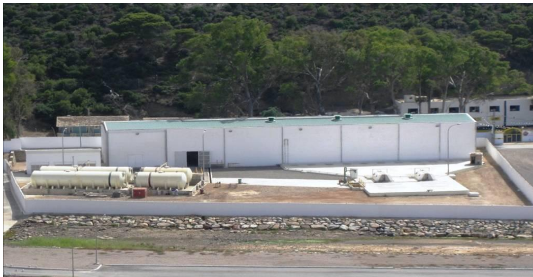
Figure III.3: Photo du poste de pompage d'eau de mer
