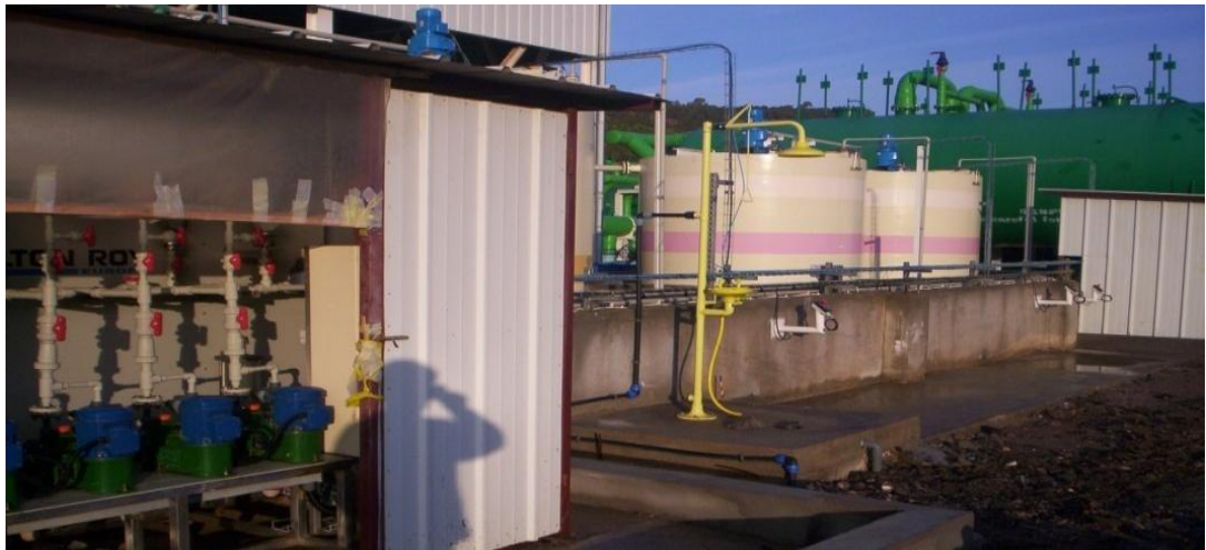
Figure III.7: Photo des citernes de stockage du métabisulfite de sodium
