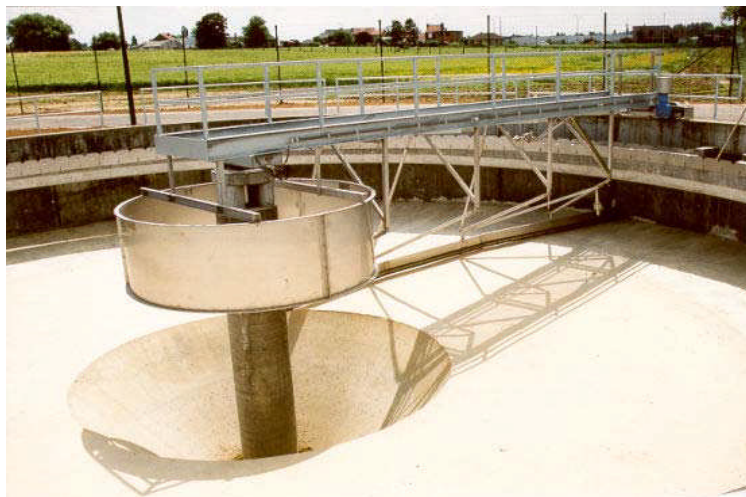
Figure 9: Décanteur primaire avec pont racleur à entraînement périphérique [66].
