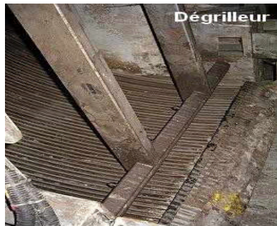
Figure 6: les grilles mécaniques [60].
