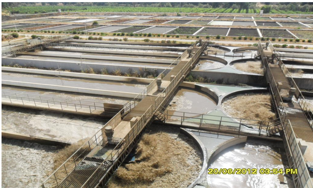
Figure IV.6 : Photo du bassin d'aération (ONA.2011).
