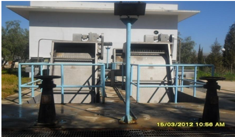
Figure IV.4: Photo d'une grille mécanisée (ONA.2012).
