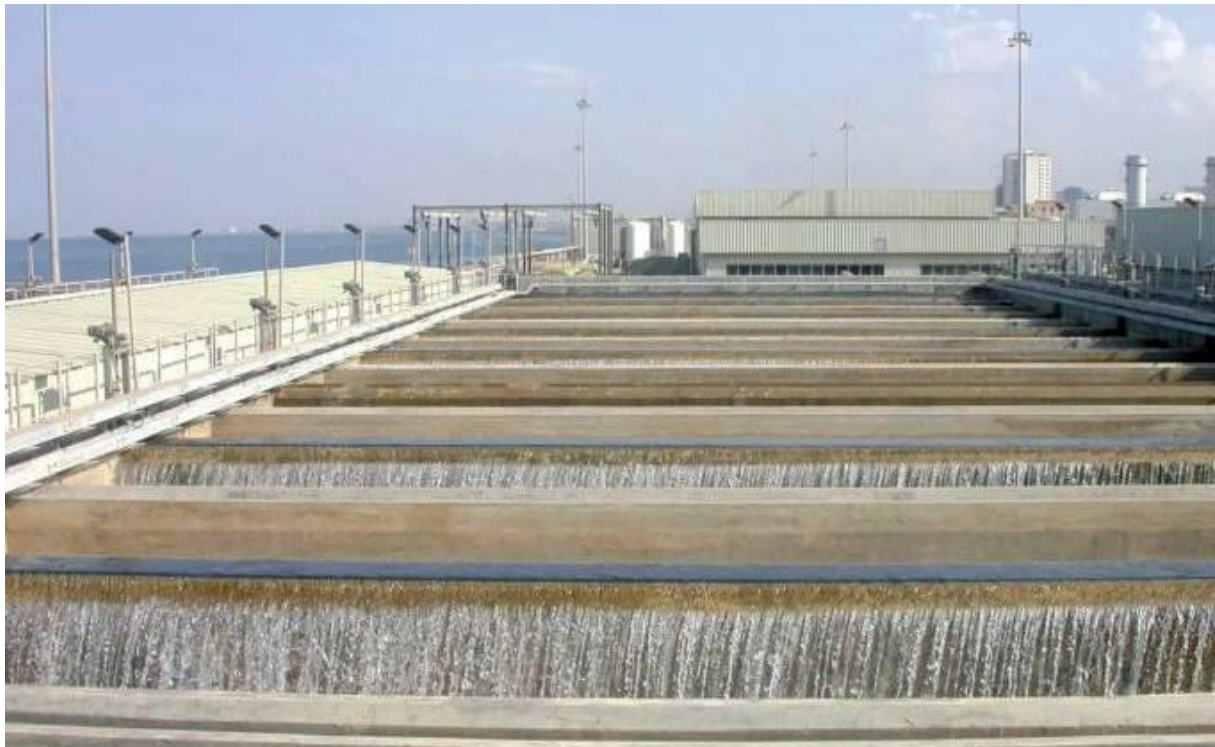
Figure III 5: Station de dessalement de Souk Tleta.
