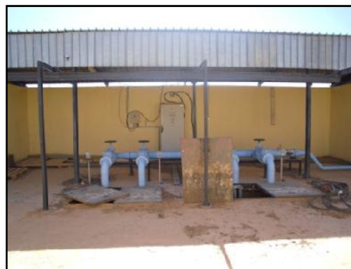
Figure I.8: station de relevage F4 vue intérieur (20/05/2012)
