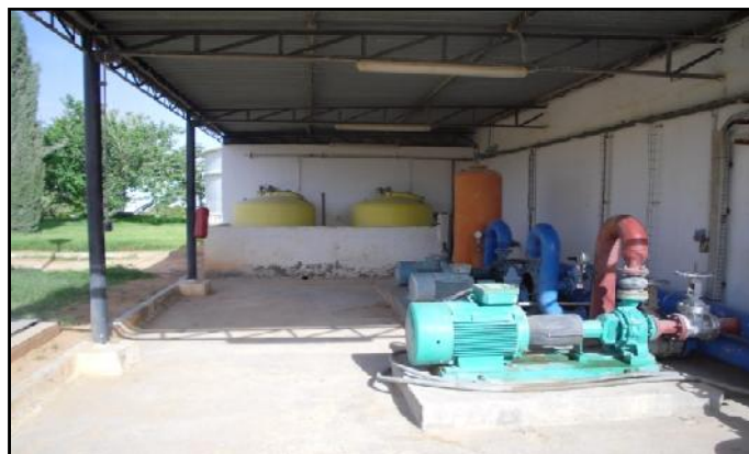
Figure III.12: Poste de désinfection (14/05/2012)
