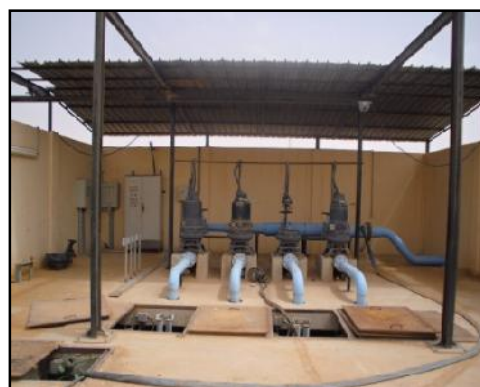
Figure I.8: Station de relevage F3 (OPGI) vue intérieure (20/05/2012)
