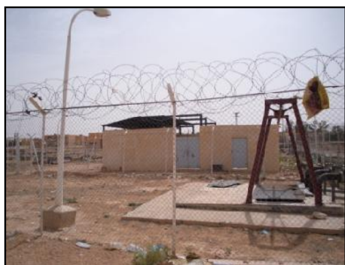
Figure I.7 : Station de relevage F3 (OPGI) vue extérieure (20/05/2012)
