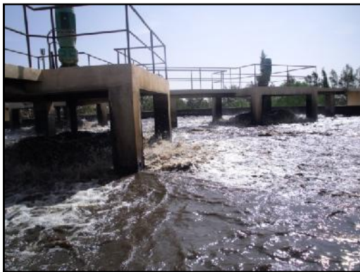
Figure III.8: Le bassin d'aération (22/05/2012)
