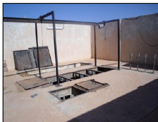
Figure I. 6: station de relevage F2 (KSL) vue intérieur (20/05/2012)
